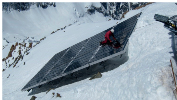
Figure 4. Capteurs solaires thermiques. Solar thermal collector.
