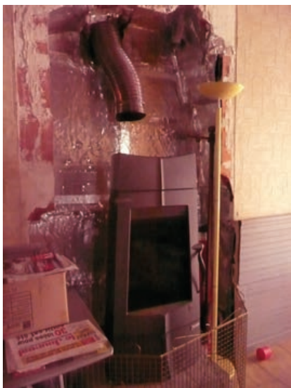
Figure 13. Un poêle à bois remplace la cheminée dans une maison d'Ille-et-Vilaine. A wood stove replaces the fireplace in a house of Ille-et-Vilaine.
